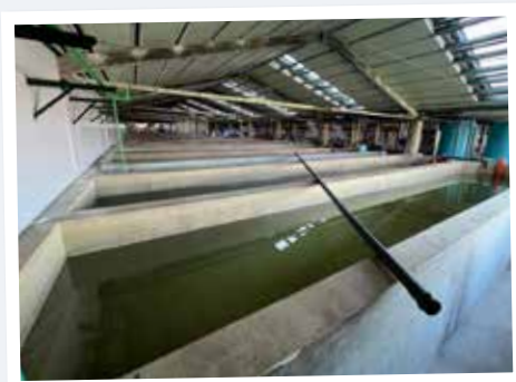
Pellestrina (Italie) – Le système VAL 600 AQUA assure la purification continue de l'eau de mer pour les coquillages, avec une consommation énergétique minimale.
